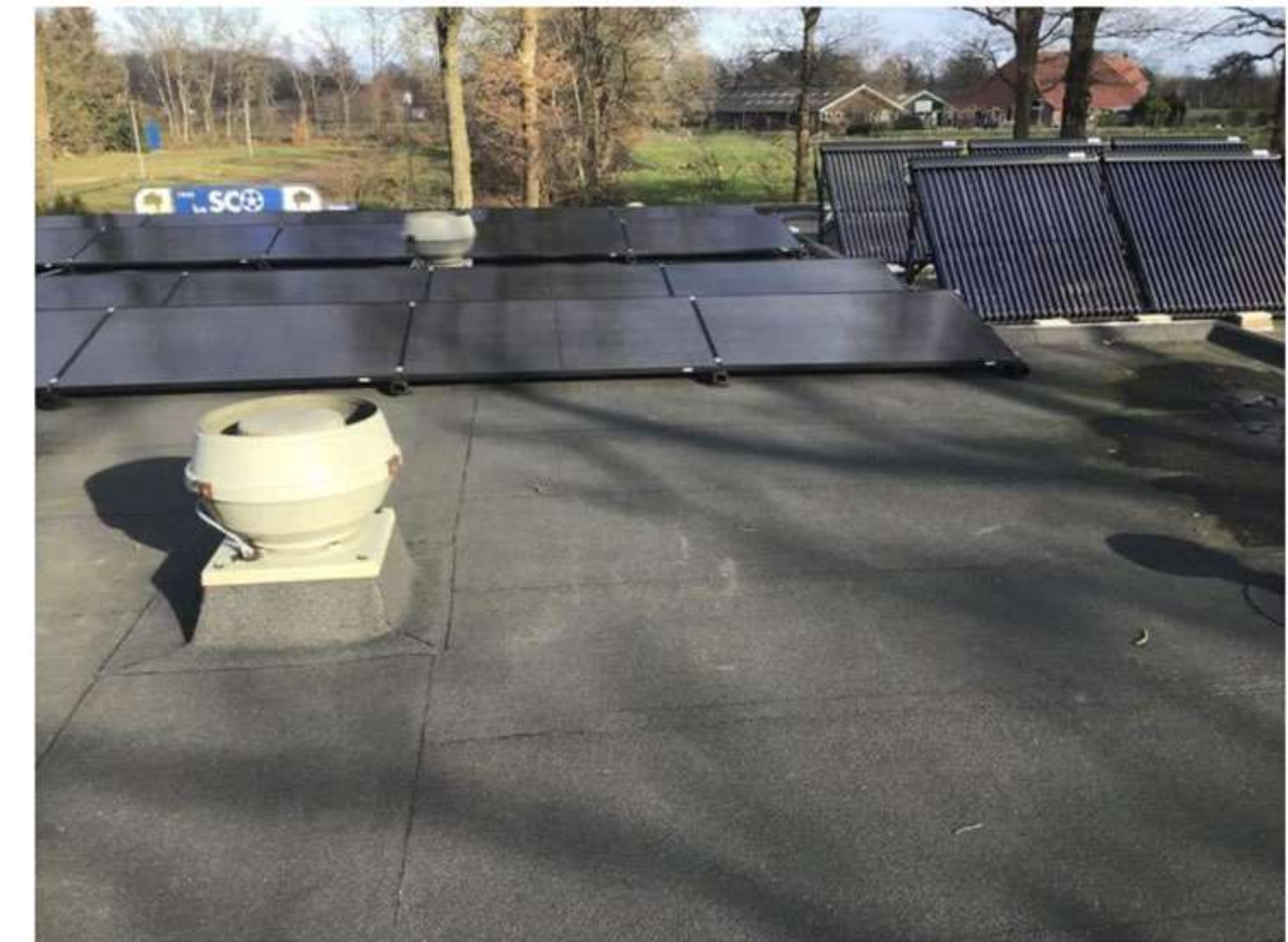
Zonnepanelen op het dak. SCO
